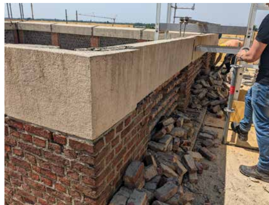
Uit de analyse van de gebruikte mortels kon al afgeleid worden dat de voegmortel meer cement bevatte dan de legmortel. De cementmortel aan het oppervlak van het metselwerk is dampdichter dan de achterliggende kalkmortel en vertraagt het uitdrogen van de kern van het metselwerk. Tijdens de werken werd dit vermoeden bevestigd: de voegmortel was nog intact, maar de achterliggende legmortel was volledig verzand (foto Sarah Lacroix)
