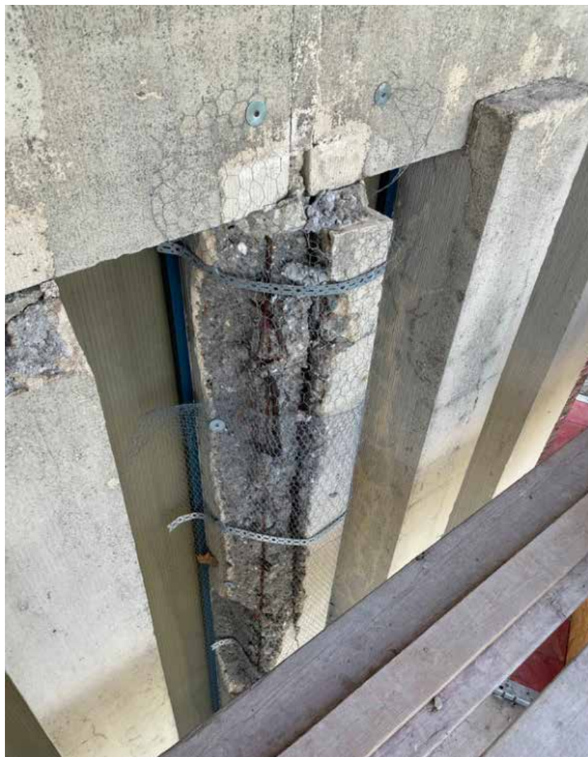
Zeer vergevorderd betonrot ter hoogte van de watertoren. Alle losse delen werden verwijderd en wapening werd hersteld. Er werd een bekisting gemaakt en deze werd opgegoten met beton.
