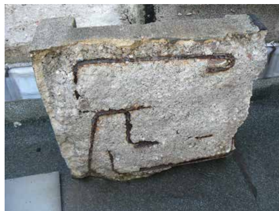
Sommige dekstenen waren volledig in tweeën gespleten door roestende wapening. Deze breuken gaven een mooi inzicht in de opbouw van de kunststeen: de betonkern heeft een oneffen oppervlak, wat doet vermoeden dat de simipleister eerst in de bekisting werd gesmeerd en het beton pas daarna werd opgegoten (foto Sarah Lacroix)
